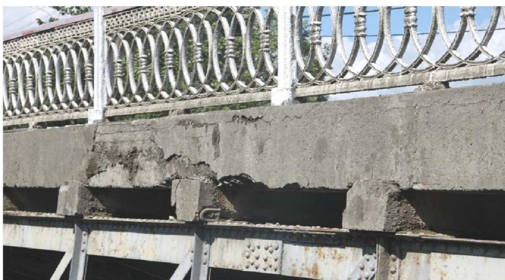
Рисунок 6 — Разрушение тротуарного блока моста через реку Буу
