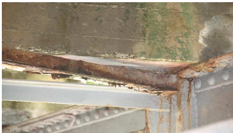
Рисунок 2 — Образование толстых окислов, отслоение окраски на диагональных связях пролетного строения моста через реку Чухук
