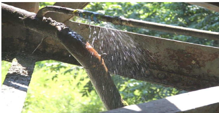
Рисунок 5 — Протечка коммуникаций, коррозия нижнего пояса пролетного строения у опоры 2 моста через реку Буу
