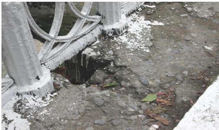
Рисунок 1 — Разрушение тротуарной плиты слева на мосту через реку Чухук
