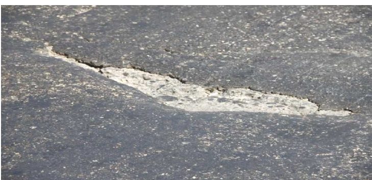
Рисунок 7 — Трещины в дорожном покрытии моста через реку Хобза
