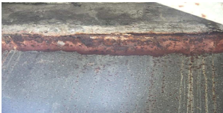
Рисунок 4 — Язвенная коррозия верхнего пояса металлической балки 3 пролетного строения моста через реку Хаджипсе
