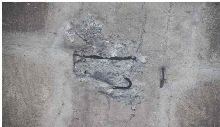
Рисунок 8 — Сколы бетона с оголением арматуры моста через реку Хобза
