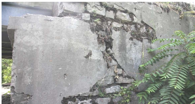
Рисунок 3 — Разрушение открьлка опоры 1 моста через реку Хаджипсе
