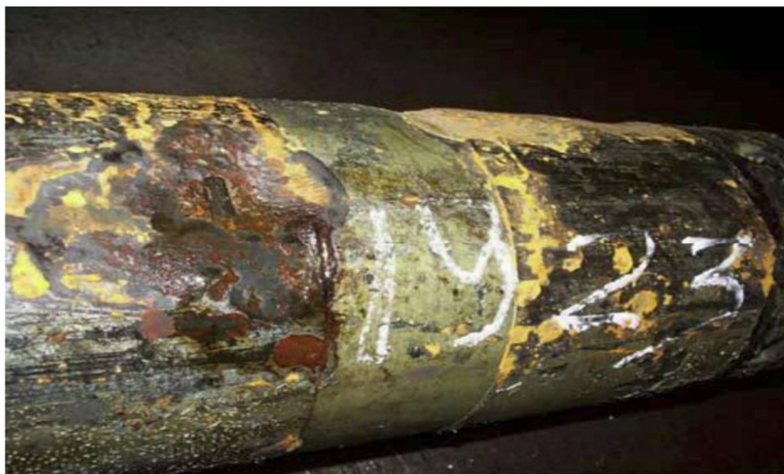
Рисунок 5 – Характер коррозионного повреждения корпуса погружного электродвигателя УЭЦН
