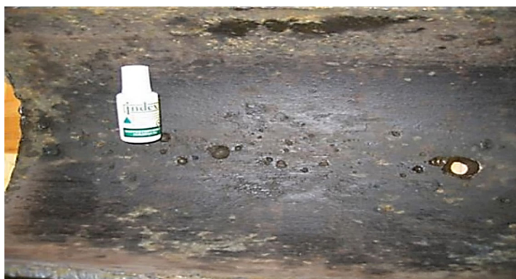
Рисунок 10 – Характер питтинговой коррозии нефтесборного трубопровода
