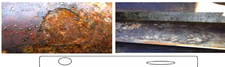
Рисунок 6 – Местная коррозия (пятнами, точками)
