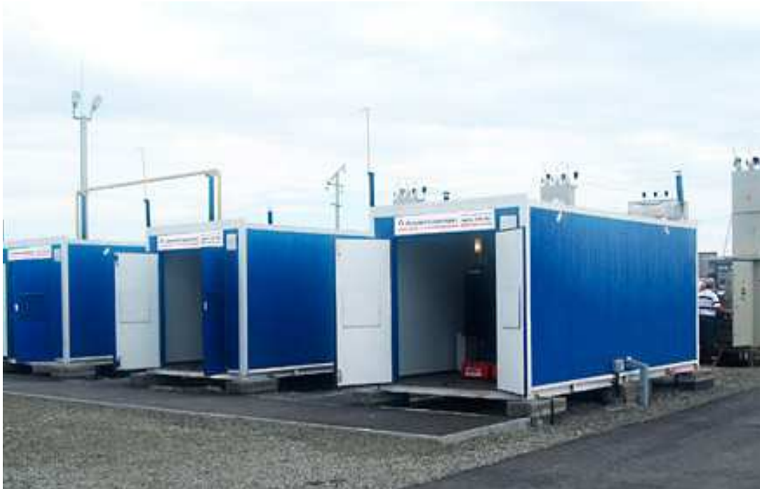
Рисунок 5 – Энергетический комплекс, состоящий из трёх ГПУ, работающих параллельно
