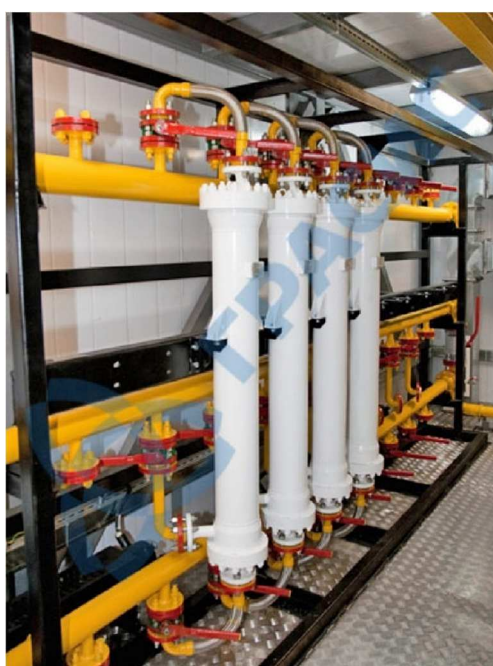
Рисунок 10 – Углеродная установка удаления сероводорода из газового потока
