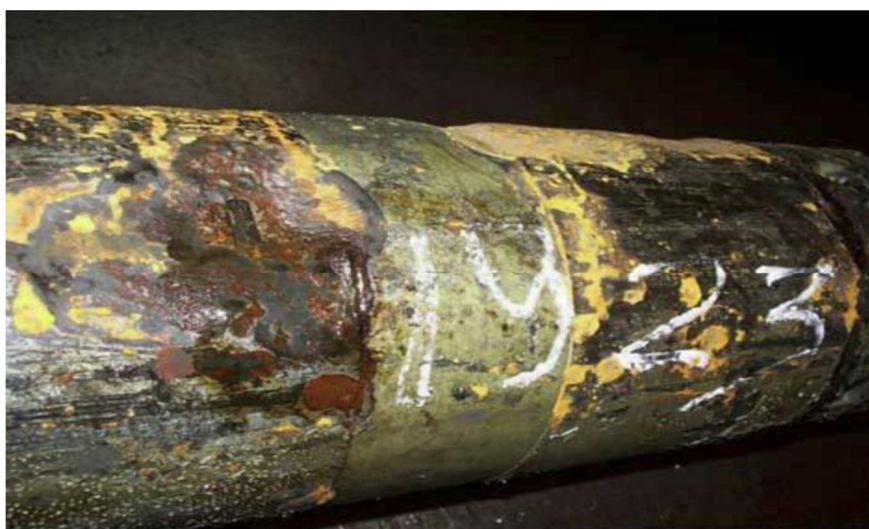
Рисунок 5 – Характер коррозионного повреждения корпуса погружного электродвигателя УЭЦН
