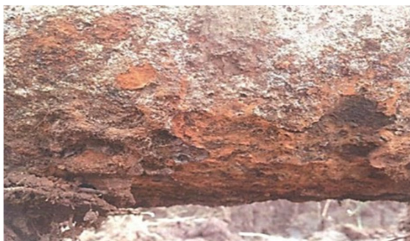
Рисунок 4 – Наружная коррозия нефтепровода под землёй на месте пересечения его с воздушной линией электропередач
