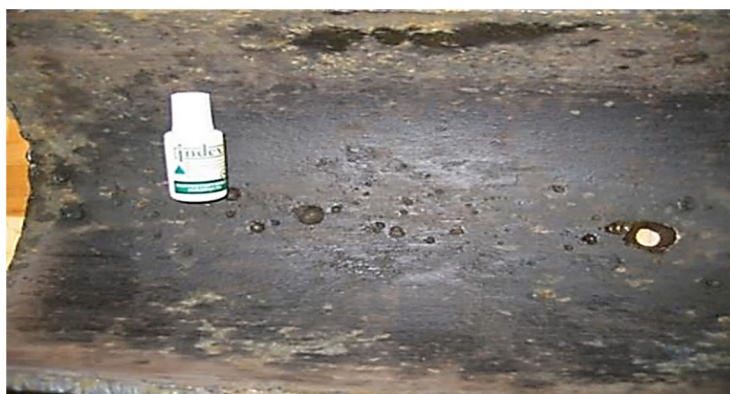
Рисунок 10 – Характер питтинговой коррозии нефтесборного трубопровода
