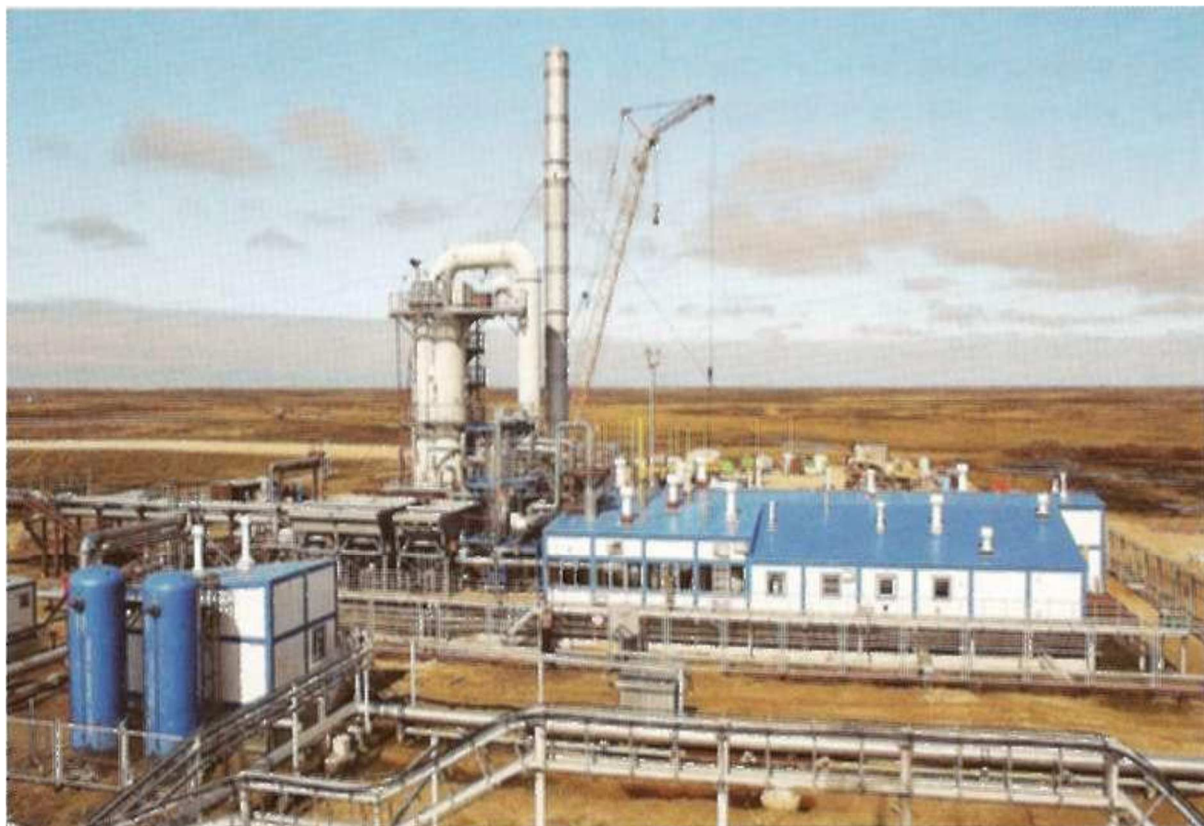
Рисунок 12 – Установка по производству метанола из метана на Юрхаровском месторождении
