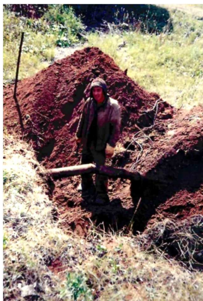
Рисунок 2 – Демонстрация обнаруженного дефекта
