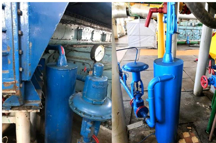
Рисунок 2 – Установленный центробежный сепаратор перед входом ГПА
