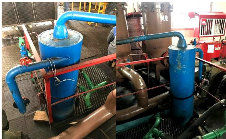
Рисунок 1 – Центробежный сепаратор для очистки входного воздуха, снятый в ремонтный период с агрегата
