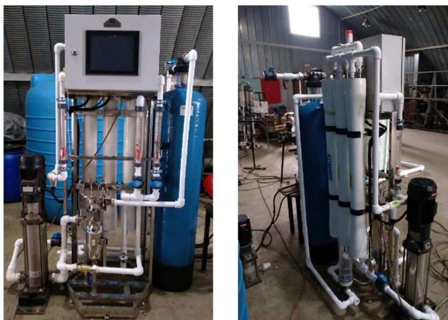
Рисунок 1 – Общий вид пилотной обратноосмотической установки производительностью 700 л/ч
