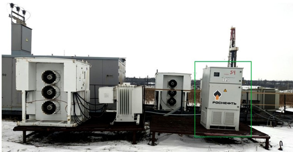
Рисунок 4 – Размещение ФСА на площадке скважины 54 Газельное м.
