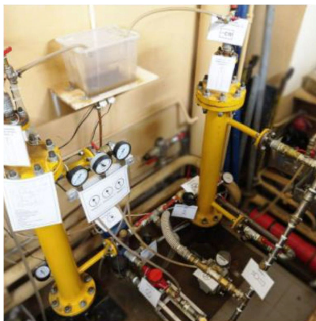
Рисунок 1 – Внешний вид новой компрессорной установки
