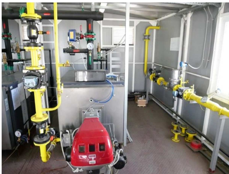
Рисунок 1 – Фотография реальной котельной
